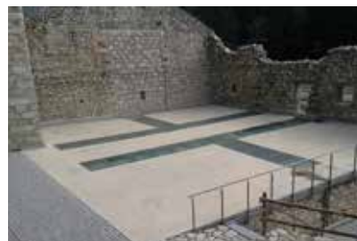
6. Le mortier autolissant Wecryl 233 égalise la surface, il ponce les fissures capillaires et fait office d'étanchéité. La mise en couleur finale a été réalisée avec la finition Wecryl 288.
