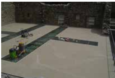
2. Le support à rénover a été nettoyé de manière adéquate, puis préparé pour le revêtement suivant.
