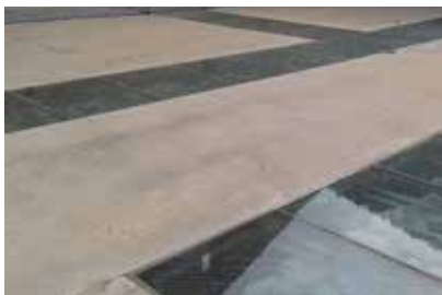
1. Le sol industriel à base de ciment, dans lequel étaient intégrés les éclairages zénithaux, s'était effrité et présentait de grosses fissures.
