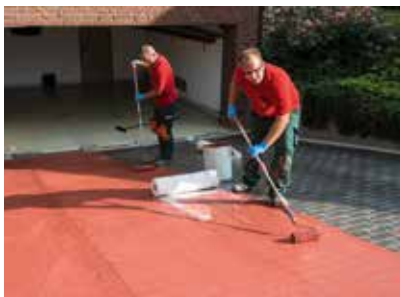
Opérations d'étanchéité sur la rampe: application de la résine - pose du voile - saturation avec la résine.
