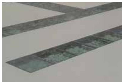
5. Les raccords le long des éclairages zénithaux ont été étanchés avec Wecryl 230 thix renforcé d'un voile.
